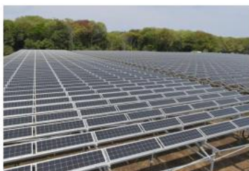
太陽光発電システム
