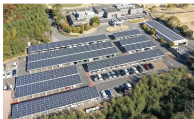
リエネ柴山ゴルフ倶楽部 太陽光発電所
