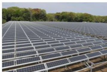
太陽光発電システム
