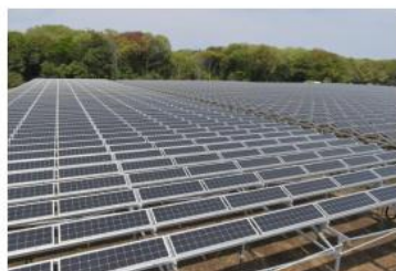
太陽光発電システム
