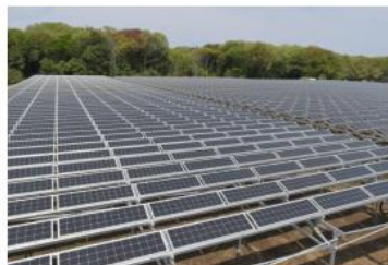
太陽光発電システム
