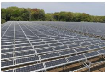
太陽光発電システム
