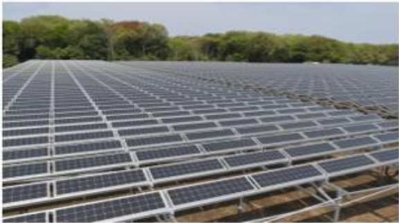
太陽光発電システム
